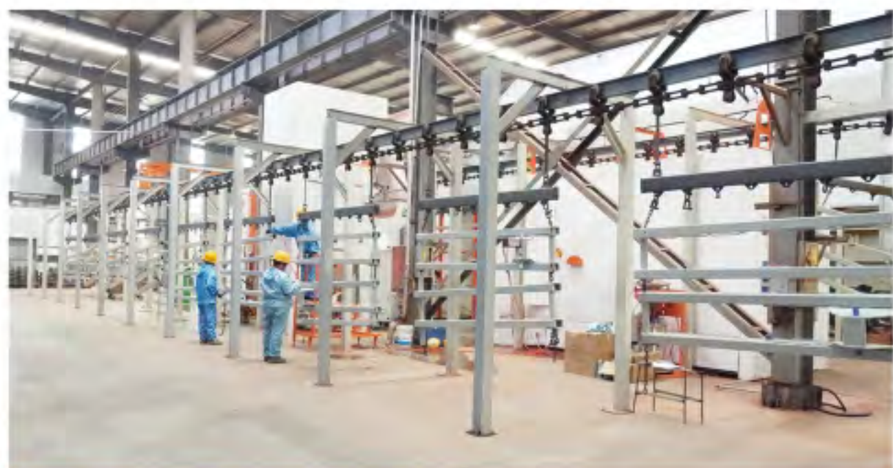
硅烷电泳静电喷塑流水线 Ⓐ
